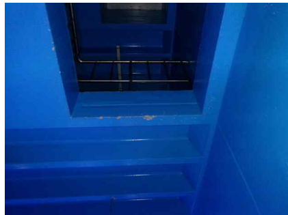
<유출밸브실 상부슬래브 파손>
