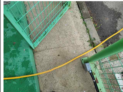
<검수실 외부 바닥 균열>
