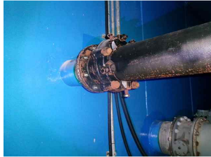
<유입밸브실 벽체 누유>
