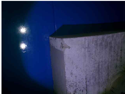
<유입밸브실 벽체 파손>
