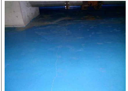
<유입밸브실 바닥슬래브 균열>
