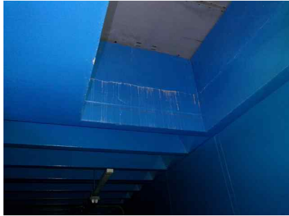
<유입밸브실 상부슬래브 백태>
