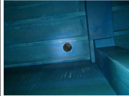
<배수지 2지 상부슬래브 백태>
