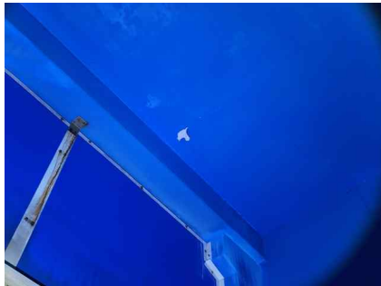
<배수지 1지 상부슬래브 도장박리>
