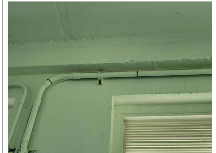
<검수실 내부 벽체 균열>
