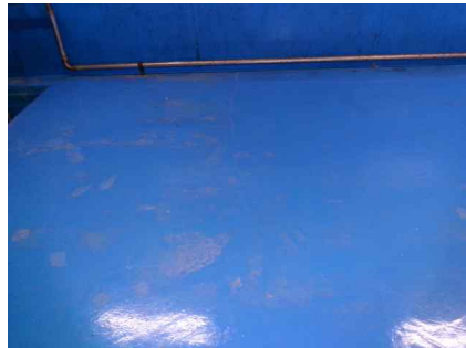
<유출밸브실 바닥슬래브 균열>
