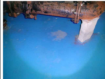
<유입밸브실 바닥슬래브 도장손상>
