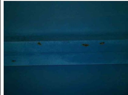
<배수지2지 상부슬래브 녹발생>
